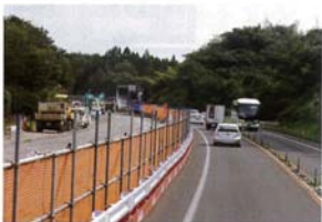
片側2車線化の工事を行う仙台東部道路。当初、石巻と仙台をつなぐ唯一の道となった
